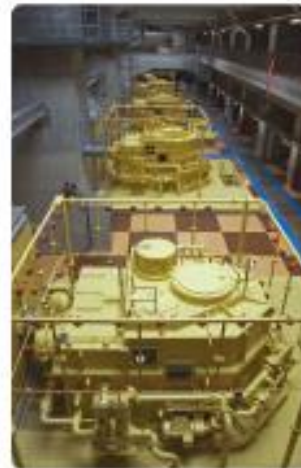
ポンプ室全景
