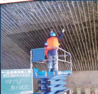
FRPグリッド増厚工事を施すためにコンクリートを剥がしたところ。昭和8年当時の鉄骨が顔を出す。日本の土木技術の高さを物語っている。
