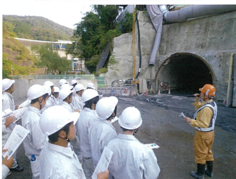
現場の方がトンネル掘削現場で減勢池部の役割を解説する
