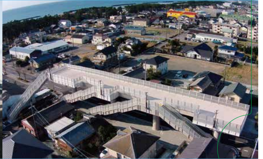
平成24年度 津波避難タワー 設置工事 〈 第31回静岡県建設業協会賞 土木部門 最優秀賞 〉
