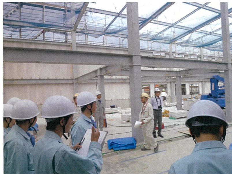
メインとなる工場棟の現場。これから本格的な工事が行われる
