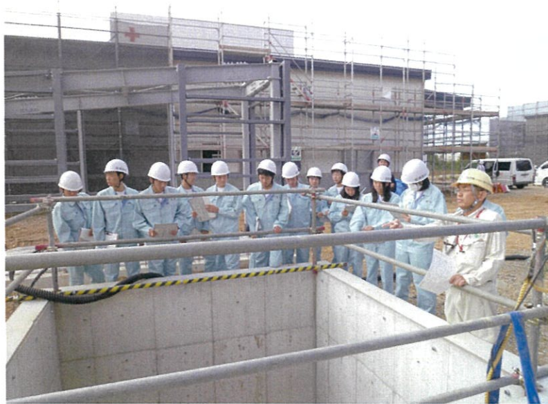
排水タンク周辺の現場。化学薬品を扱う工場には必須の設備だ。
