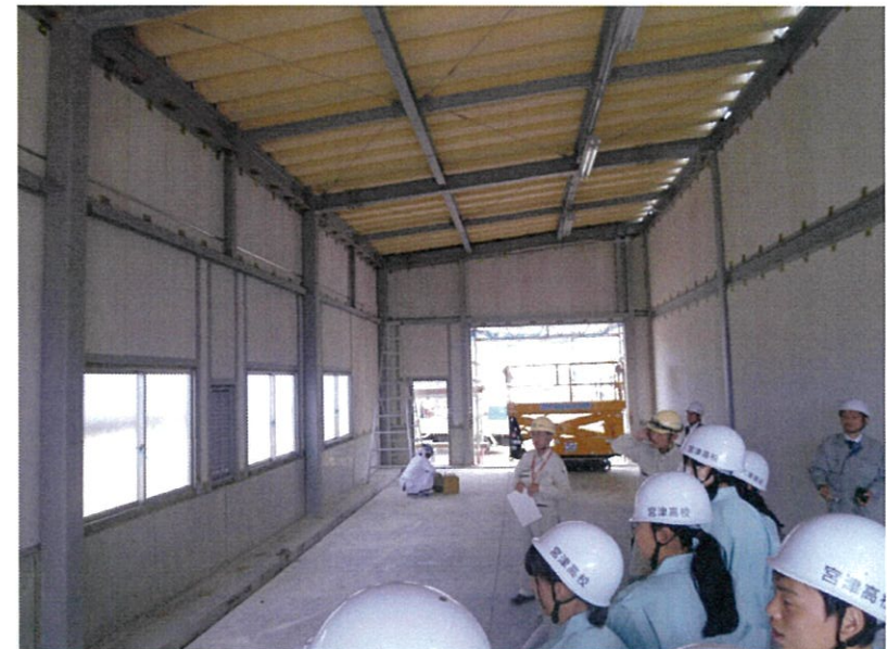
この棟は、原材料の保管倉庫になる。屋根はあるが、進捗率はまだ半分。
