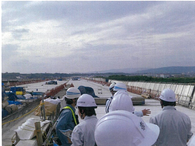
木津川橋は鋼鉄とコンクリート。交差条件で異なる2素材の橋桁から成る。
