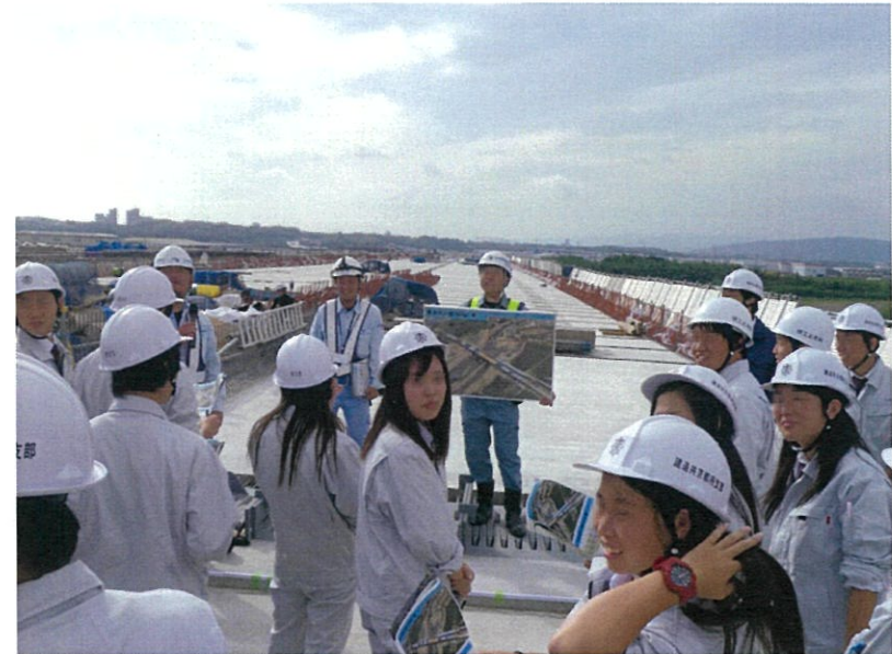
木津川橋-JCT間の接続部。足元8cmの段差にアスファルトが敷かれる。
