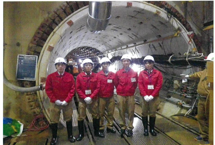
実習先での1枚。浸水被害から市民を守る巨大な地下雨水トンネルを作っている。
