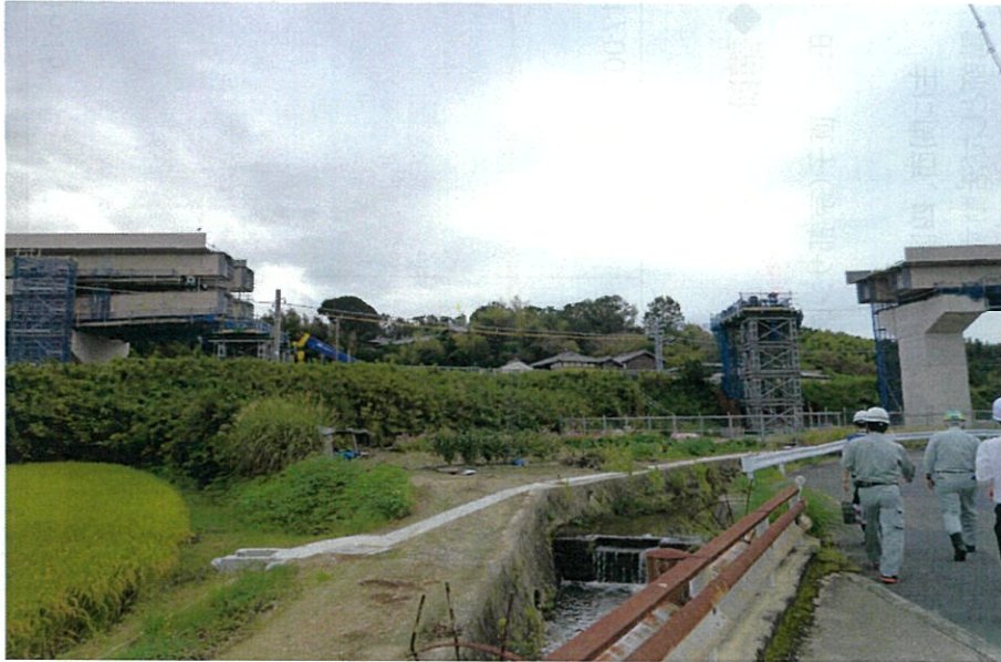
着々と工事が進む現場。高架橋は今、まさに大和路線を跨ごうとしている。
