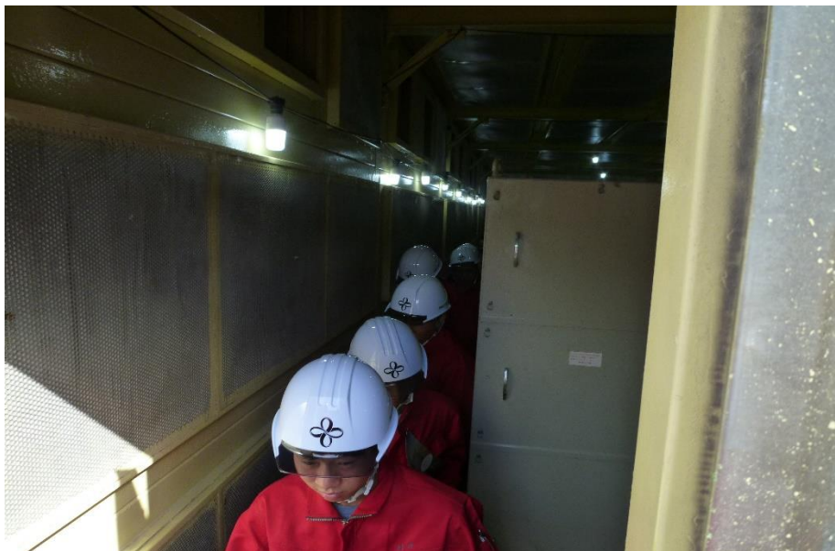
圧縮空気を作るエアコンプレッサーがある部屋へ。あまりの音の大きさに生徒も困惑気味。
