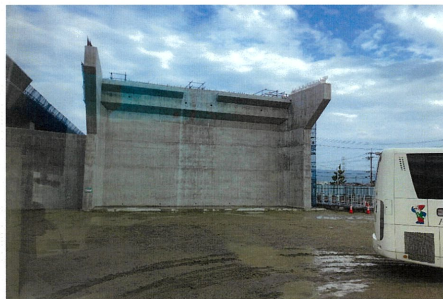
宇治田原へ向かう道中、車窓より城陽JCT連絡橋の下部工を見る事が出来た。
