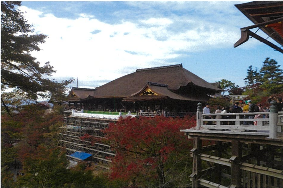
50年ぶりに葺替えられた本堂屋根。檜皮取り職人の減少もあり、工期はかなりの時間を要した。
